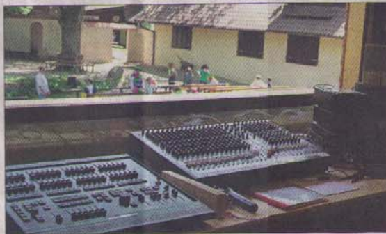
Mischpult und Kabelsalat: Beim Tag der offenen Tür zeigt auch das vor sechs Jahren errichtete Technikhaus, was in ihm steckt
